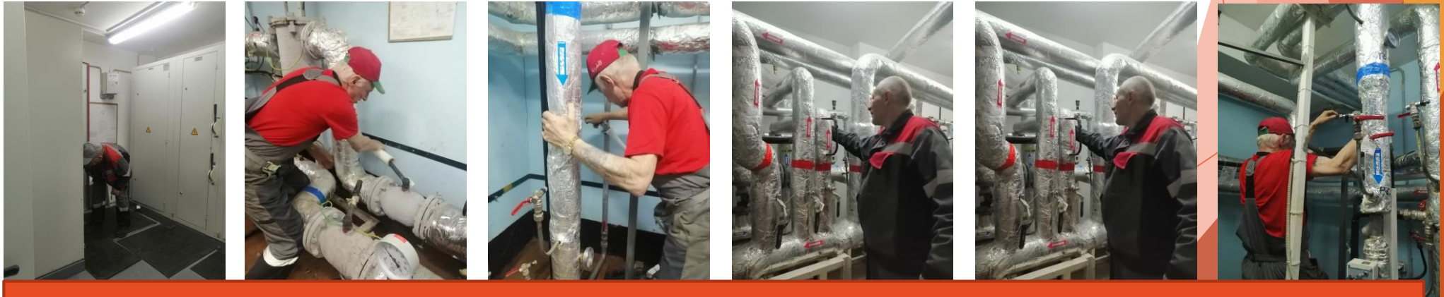
- Закрытие задвижек в ИТП - Осмотр ВУ и ИТП
