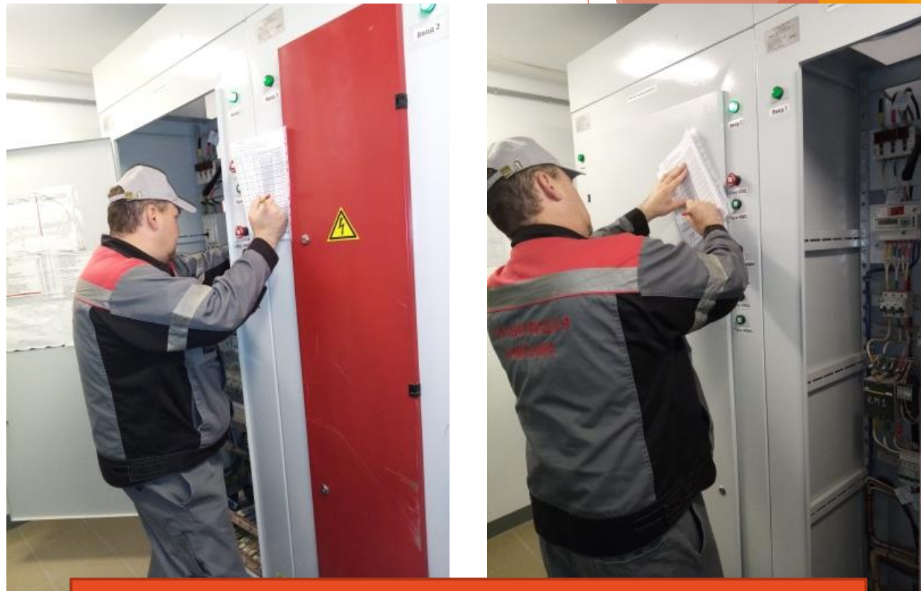
Снятие показаний в ИТП
